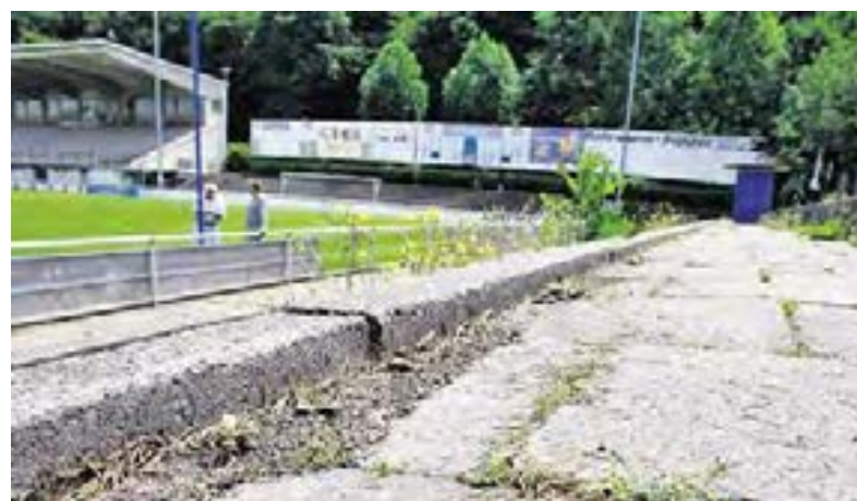
Für Schlagzeilen sorgte der baulich schlechte Zustand des Stadions Holzhof vor allem wegen Veranstaltungen, die dort nicht stattfinden konnten. FOTOS: KETTERL, PZ-ARCHIV
